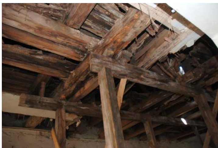
Obr. 90: Žihle zámek - Místnost nad průjezdem - propadlý strop (foto: Stráník)
