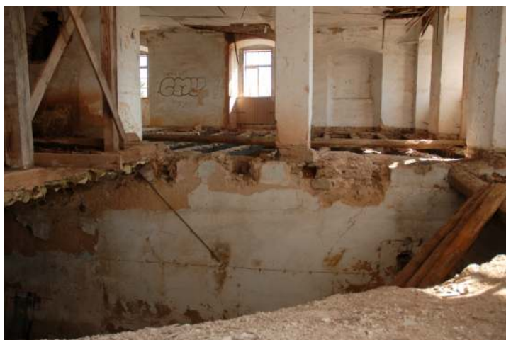
Obr. 81: Žihle zámek - Propadá podlaha v prvním patře nad průjezdem (foto: Stráník)
