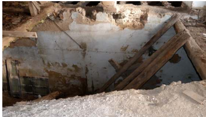
Obr. 88: Žihle zámek - Propadlá podlaha v prvním patře nad průjezdem (foto: Stráník)
