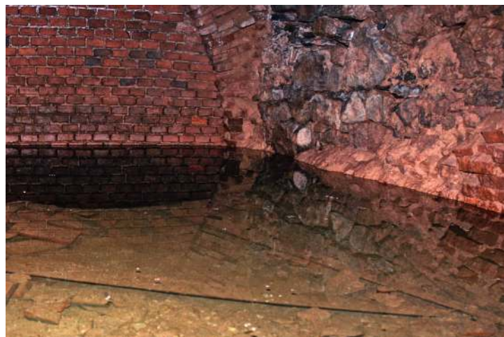
Obr. 45: Žihle zámek - rozpadající se cihlová klenba sklepení (foto: Stráník)
