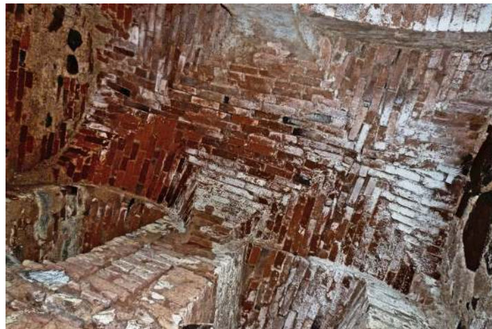
Obr. 39: Žihle zámek - Klenební systém na podestě ve sklepení s dvěma zadržnými okny (foto: Stráník)
