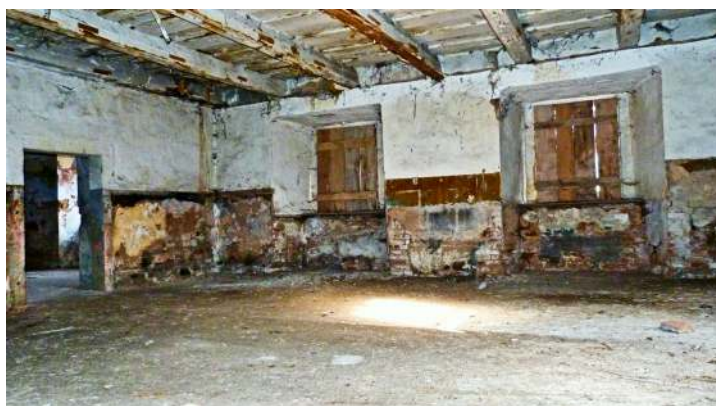
Obr. 67: Žihle zámek - jihovýchodní velká místnost s původním trémovým záklopkovým stropem, foceno od západu (foto: Stráník)
