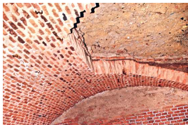
Obr. 47: Žihle zámek - rozpadající se cihlová klenba sklepení (foto: Stráník)
