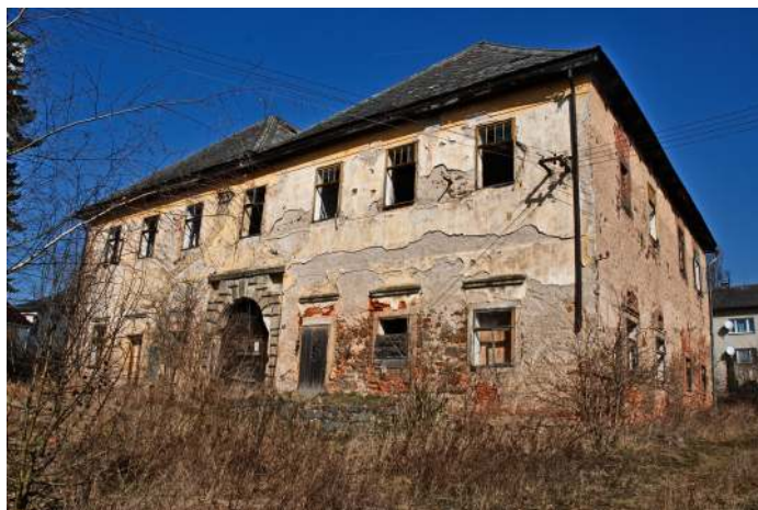
Obr. 28: Žihle - stav zámku v roce 2014 (foto: Stráník)
