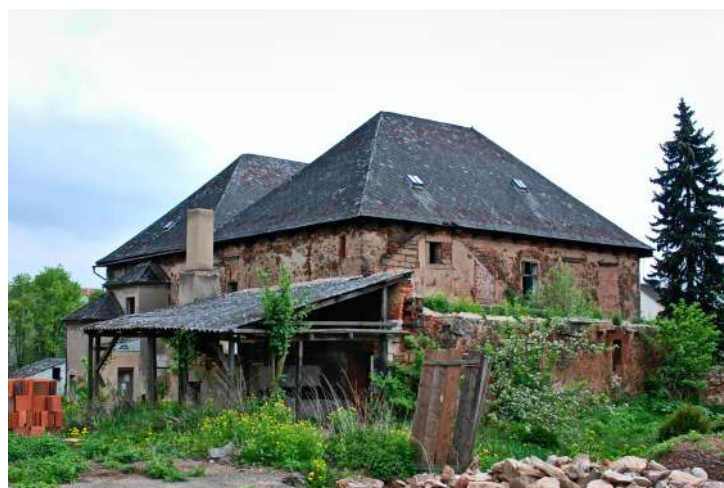
Obr. 20: Žihle - stav zámku v roce 2009 (foto: Stráník)
