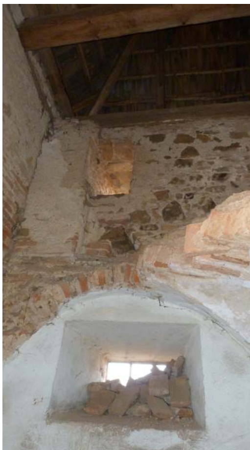
Obr. 106: Žihle zámek - propadlá klenba v mezipatře (foto: Stráník)
