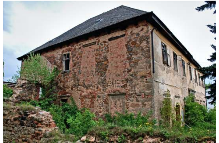
Obr. 25: Žihle - stav zámku v roce 2009 (foto: Stráník)
