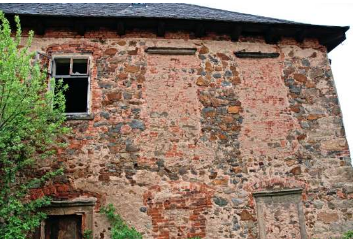
Obr. 26: Žihle - stav zámku v roce 2009 (foto: Stráník)
