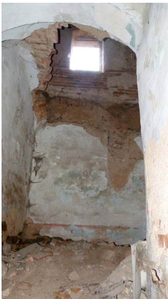
Obr. 107: Žihle zámek - propadlá klenba v mezipatře (foto: Stráník)
