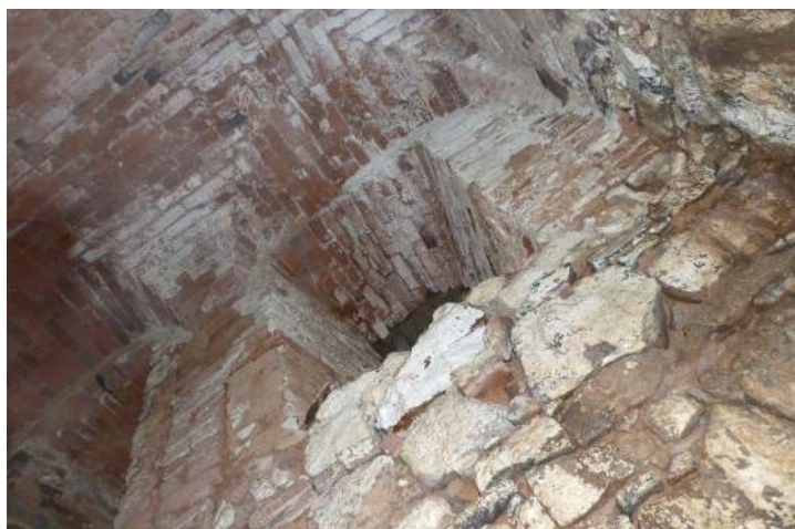
Obr. 38: Žihle zámek - Okno na podestě ve sklepení s náběhy klenebního systému (foto: Stráník)
