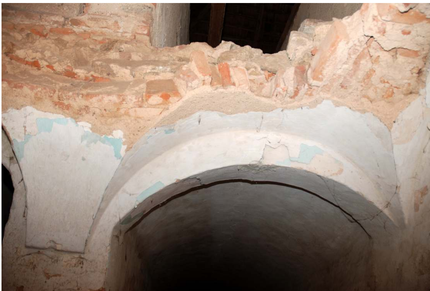
Obr. 115: Žihle zámek - pohled zespoda na propadlou klenbu v mezipatře (foto: Stráník)
