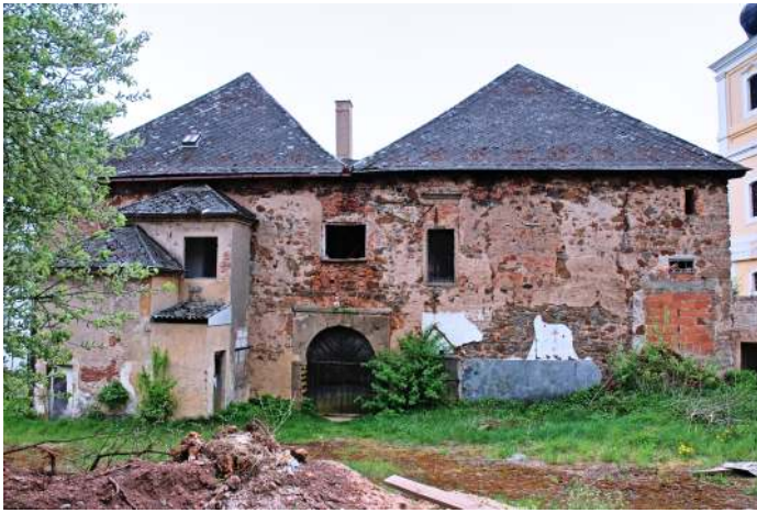
Obr. 22: Žihle - stav zámku v roce 2009 (foto: Stráník)
