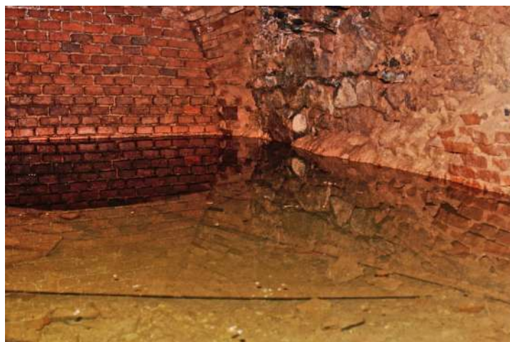
Obr. 46: Žihle zámek - rozpadající se cihlová klenba sklepení (foto: Stráník)
