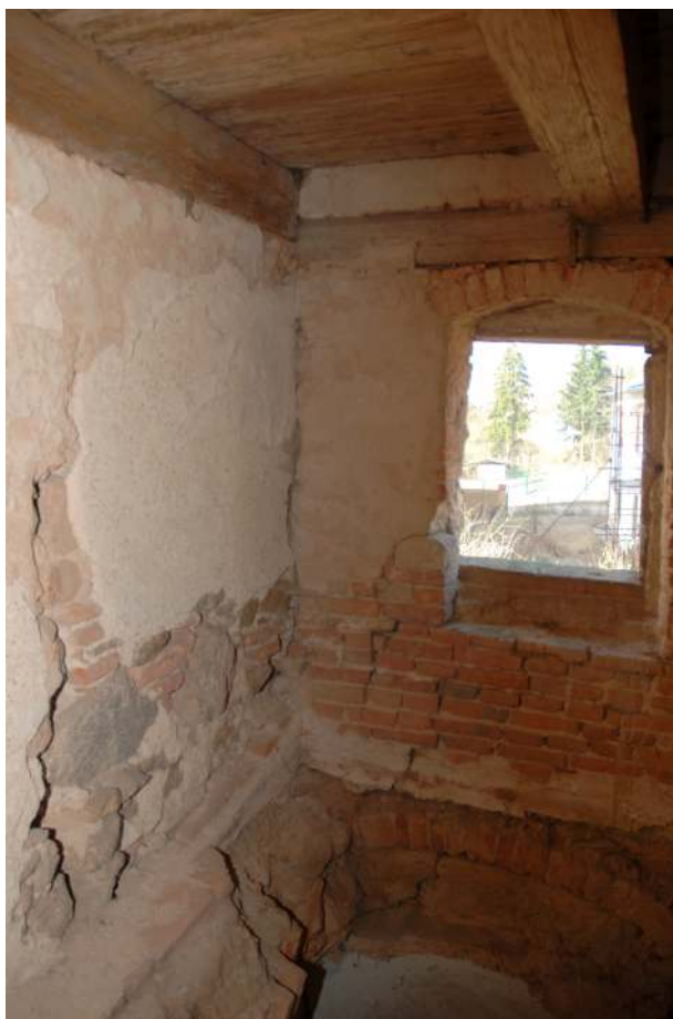
Obr. 110: Žihle zámek - propadlá klenba v mezipatře (foto: Stráník)
