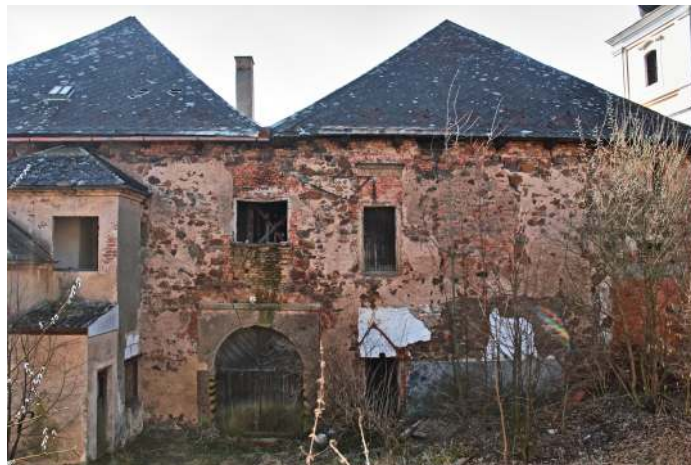
Obr. 29: Žihle - stav zámku v roce 2014 (foto: Stráník)
