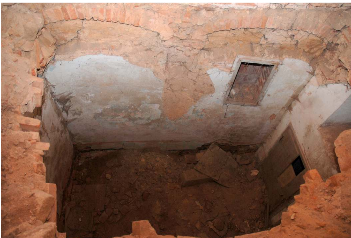
Obr. 113: Žihle zámek - pohled shora na propadlou klenbu v mezipatře (foto: Stráník)
