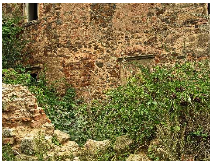
Obr. 19: Žihle - stav zámku v roce 2004 (archiv MT)
