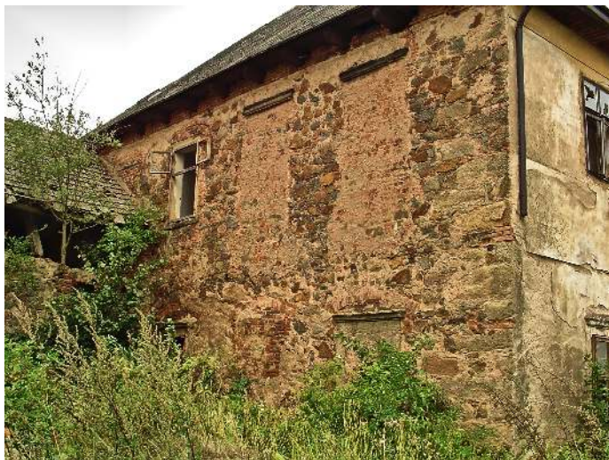
Obr. 18: Žihle - stav zámku v roce 2004 (archiv MT)
