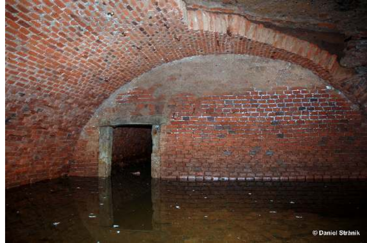
Obr. 43: Žihle zámek - rozpadající se cihlová klenba sklepení (foto: Stráník)
