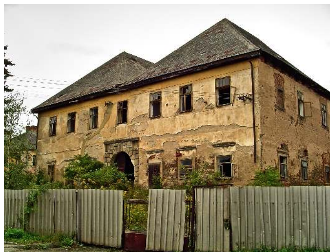
Obr. 17: Žihle - stav zámku v roce 2004 (archiv MT)
