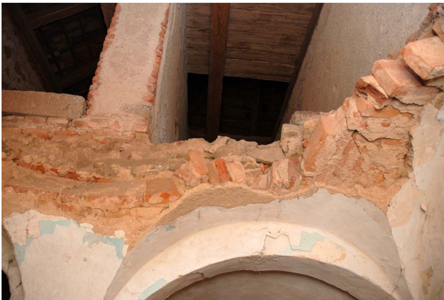
Obr. 114: Žihle zámek - pohled zespoda na propadlou klenbu v mezipatře (foto: Stráník)
