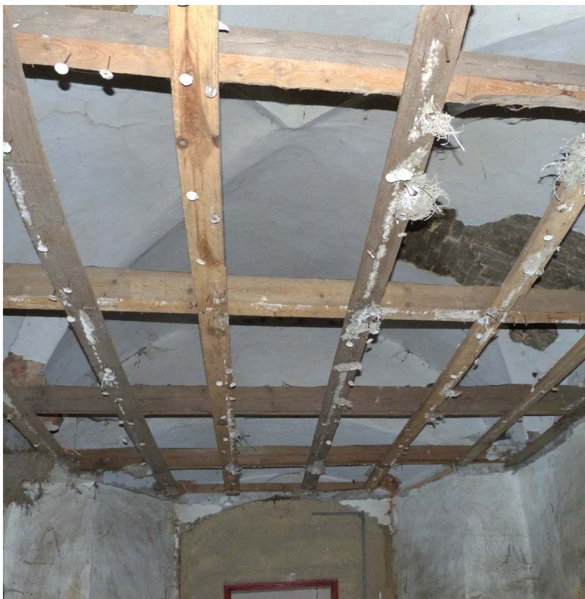
Obr. 60: Žihle zámek - Detail laťování stropu a valené křížové klenby v místnosti navazující na průjezd v přízemí foceno od jihozápadu (foto: Stráník)
