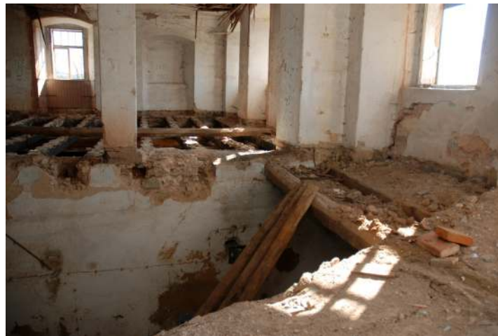
Obr. 82: Žihle zámek - Propadá podlaha v prvním patře nad průjezdem (foto: Stráník)
