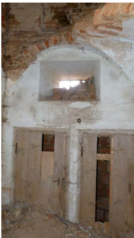
Obr. 105: Žihle zámek - propadlá klenba v mezipatře (foto: Stráník)
