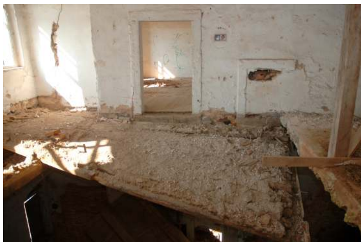
Obr. 92: Žihle zámek - Místnost nad průjezdem - propadlá podlaha (foto: Stráník)
