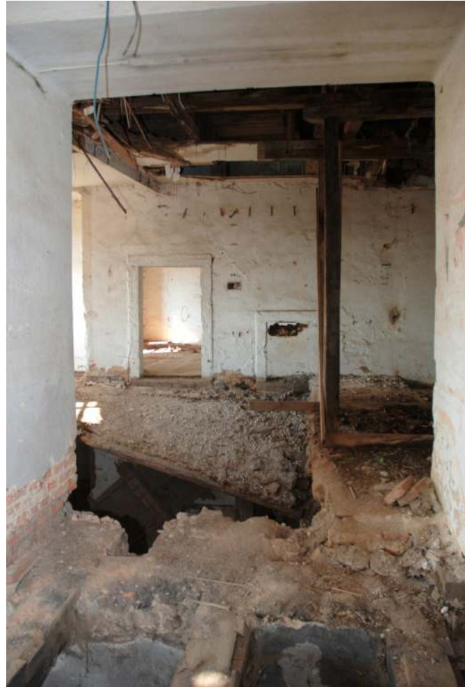
Obr. 94: Žihle zámek - Propadlá podlaha v prvním patře nad průjezdem (foto: Stráník)
