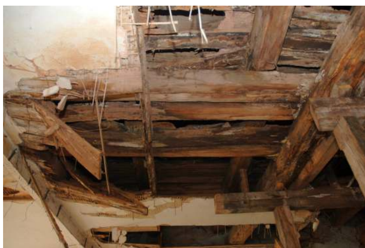
Obr. 86: Žihle zámek - Místnost nad průjezdem - propadlý strop (foto: Stráník)
