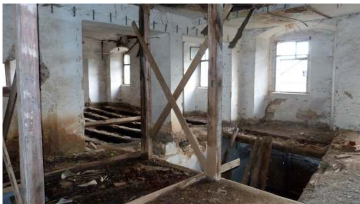
Obr. 87: Žihle zámek - Propadlá podlaha v prvním patře nad průjezdem (foto: Stráník)
