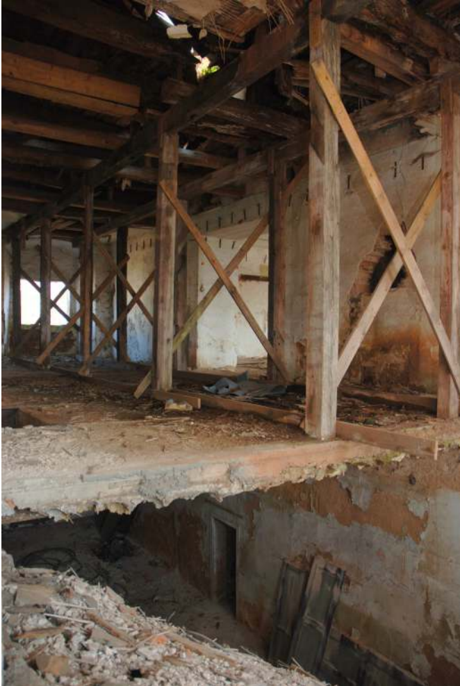
Obr. 93: Žihle zámek - Propadlá podlaha v prvním patře nad průjezdem (foto: Stráník)
