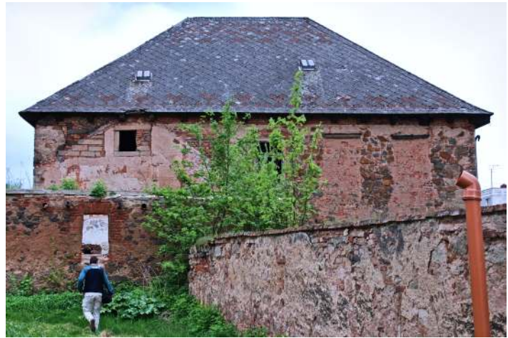
Obr. 23: Žihle - stav zámku v roce 2009 (foto: Stráník)
