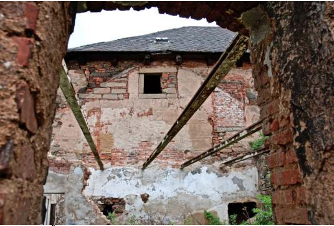
Obr. 24: Žihle - stav zámku v roce 2009 (foto: Stráník)
