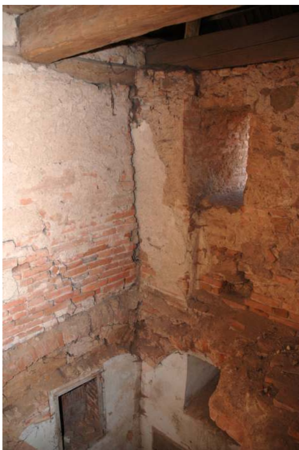
Obr. 109: Žihle zámek - propadlá klenba v mezipatře (foto: Stráník)
