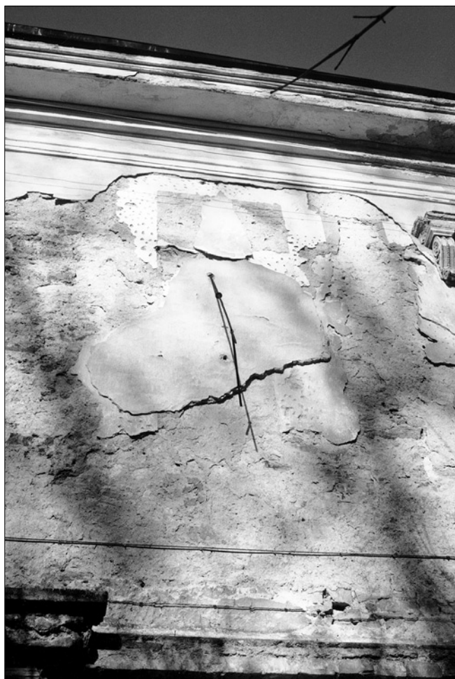
Obr. 9: Zámek Právoňín, detail otisků lizén a rámtů na barokní omítce západní poloviny jižního průčelí.
