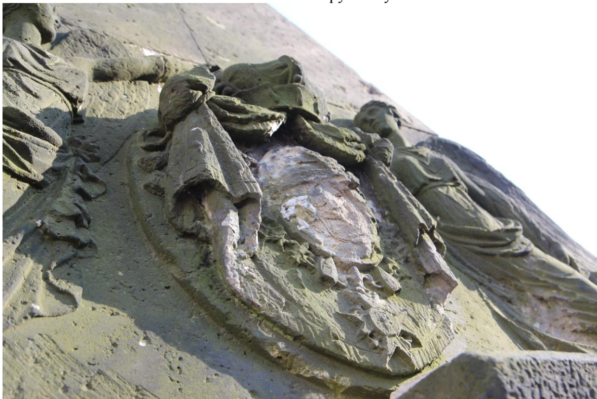
Detail poškození reliéfu
