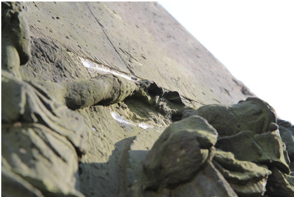
Detail reliéfu s nekvalitně provedeným druhotným spárováním
