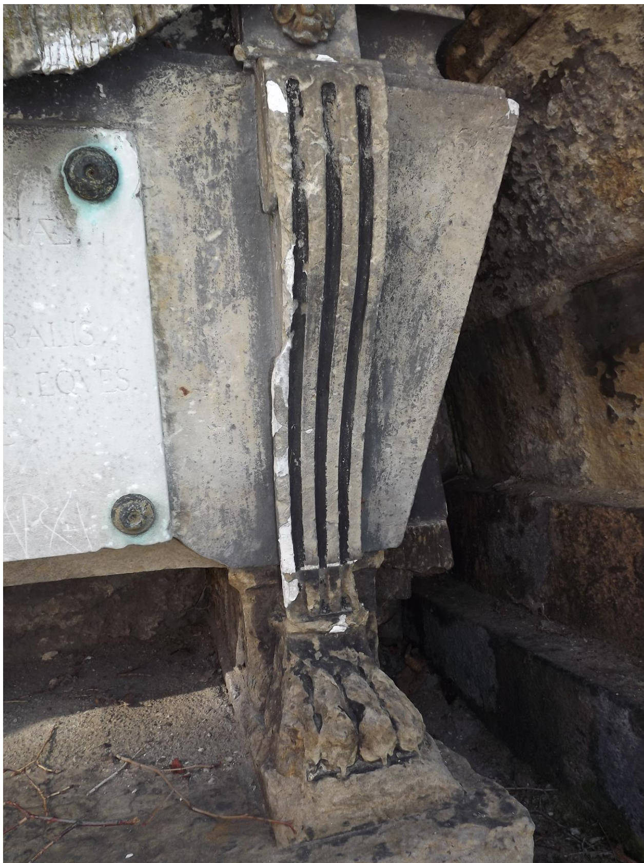
Silně degradovaná noha sarkofágu s plastickým poškozením, plombami a fragmenty polychromie
